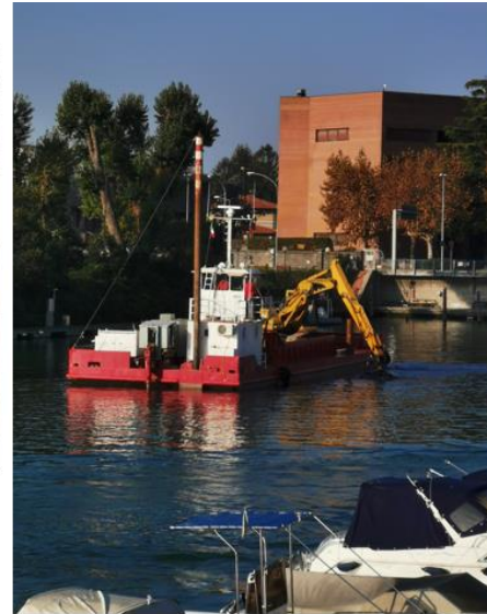
Lavori di dragaggio del Canale Valentinis (OP.180) per euro 157.525,426 + trasporto e conferimento dei sedimenti marini presso l'impianto di recupero per euro 1.097.000,00 per un totale di euro 1.430.232,97 (IVA esclusa)
